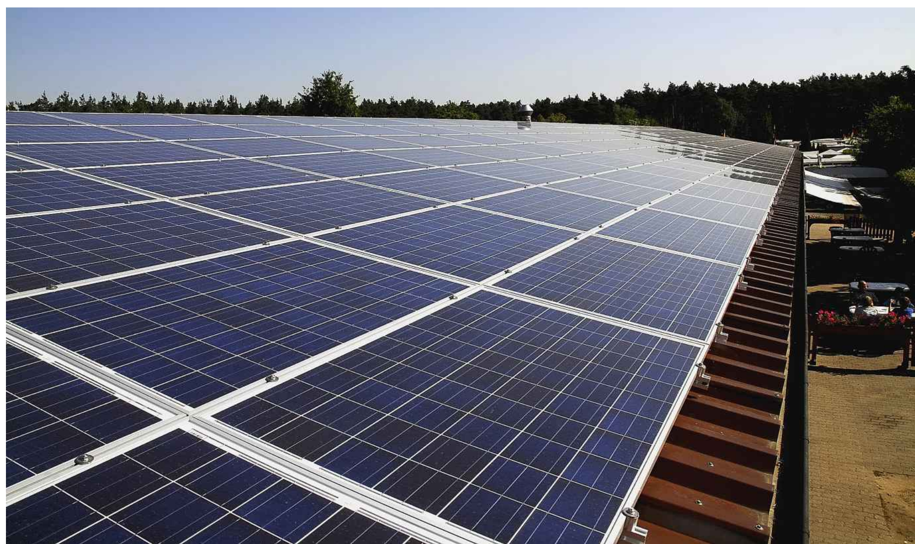
280 Quadratmeter Fotovoltaik-Module sind auf dem Dach des Versorgungsgebäudes auf dem Campingplatz installiert. Es ist das größte der drei Karlsteiner Solar-Projekte.
